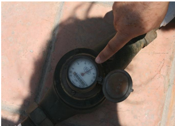
Figura 7.5.3. Aforador de engranes
