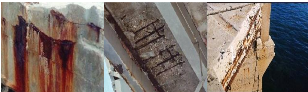
Figura 7.- Ejemplos de corrosión
