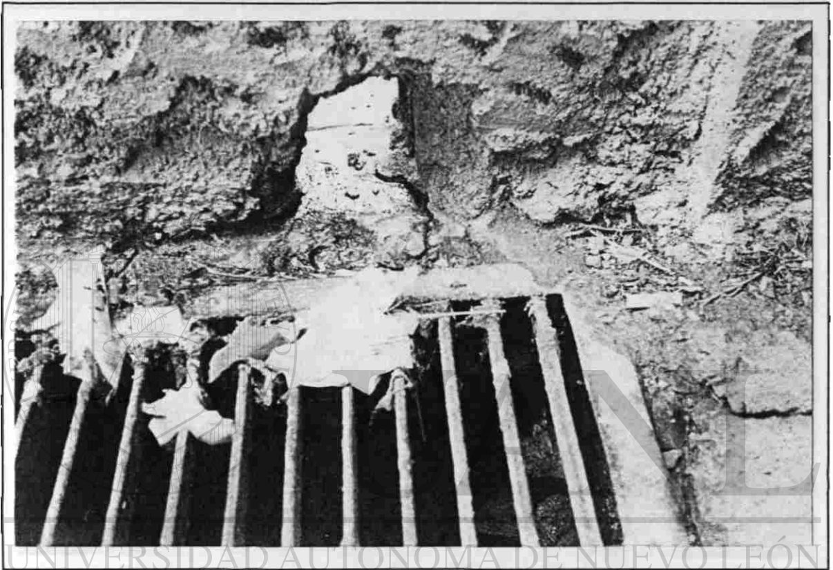
FOTO 9. DRENAJE PLUVIAL CON REJILLA. Se observa rejilla con basura y el hueco de la pared por donde se derraman los líquidos de las bolsas con residuos sólidos, en el almacén central.
