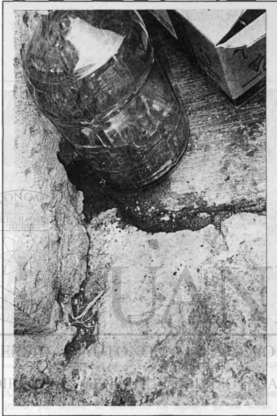
FOTO 8. ALMACEN CENTRAL. Se observa el derrame del líquido que pasa a través de un hueco de la pared del almacén.
