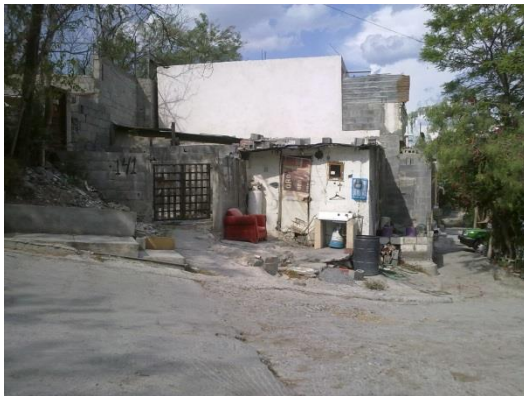
Foto 4.7. Vivienda en las márgenes del río Santa Catarina. Reparaciones a la vivienda con materiales de desecho
