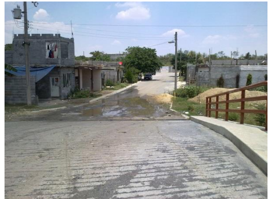
Foto 4.2. Banquetas en mal estado y encharcamientos
