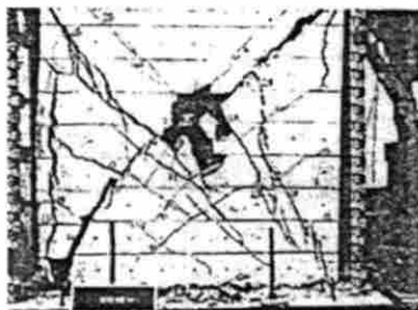
Modo de falla por cortante
