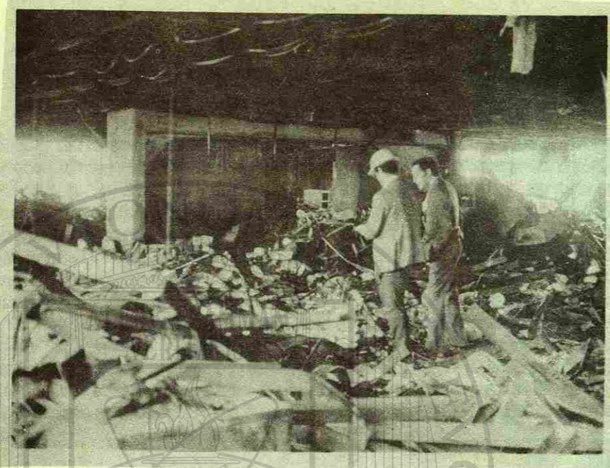
Fig. 9.- Un piso típico después del incendio.
