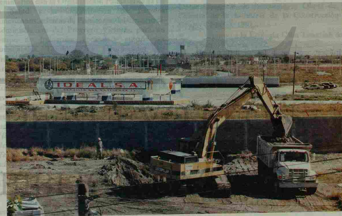
La proximidad de una gasera representó un riesgo adicional.
